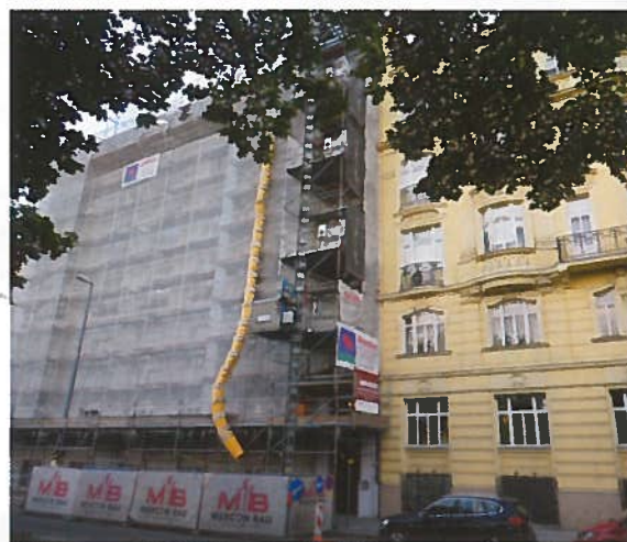
Energetska prenova stavb kulturne dediščine predstavlja izziv za načrtovalce, investitorje in izvajalce, vir: Neva Jejčič
